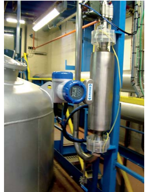
Typische Installation in einem Chemiewerk
